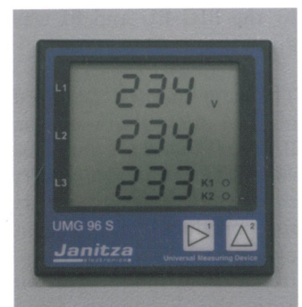
Der Lastgangzähler wird mittels Modbus/TCP-Protokoll an die GLT gekoppelt. The load counter is coupled via Modbus / TCP protocol to the BMS.
